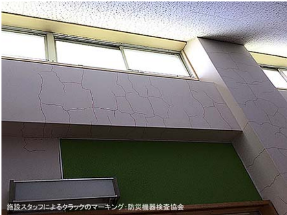
施設スタッフによるクラックのマーキング: 防災機器検査協会
